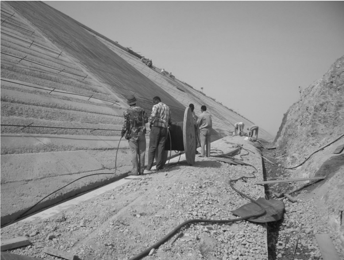
Bild 2: Midlands Dam Mauritius – Verlauf des faseroptischen Leckortungskabels
