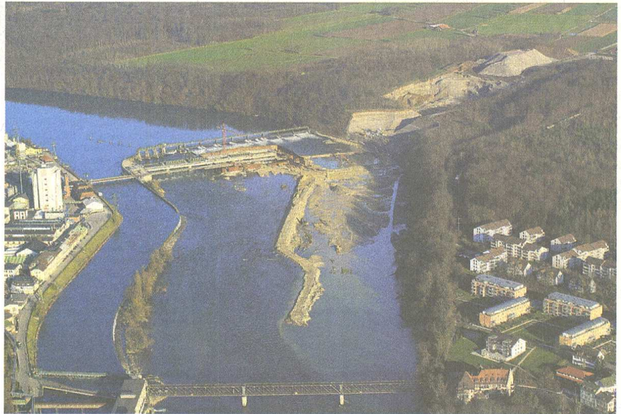
Ein Laufwasserkraftwerk mit 100 MW Leistung wird in Rheinfelden am Oberlauf der Rheins gebaut. Die Genehmigung konnte erreicht werden, weil es dort bereits eine ältere Anlage gab. Das Maschinenhaus steht rechts auf dem Schweizer Rheinufer. Foto: Energiedienst
